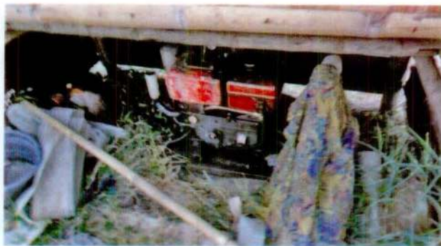
Foto 21. Diesel Untuk Memompa Air Dari Mata Air.
