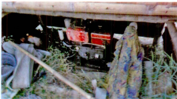
Foto 21. Diesel Untuk Memompa Air Dari Mata Air.
